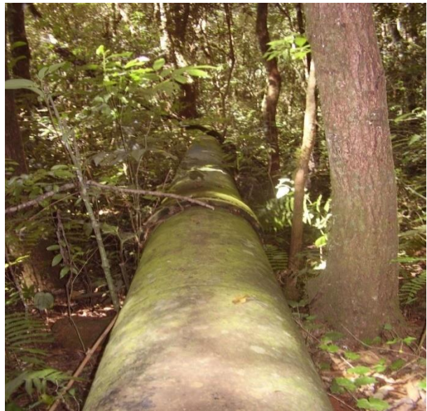
Figura 6 - Tubulação Usina Elétrica
